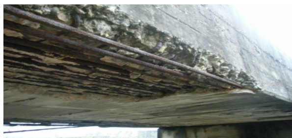
図-1 RC 橋梁の被りの剥落と鉄筋腐食状況の一例
