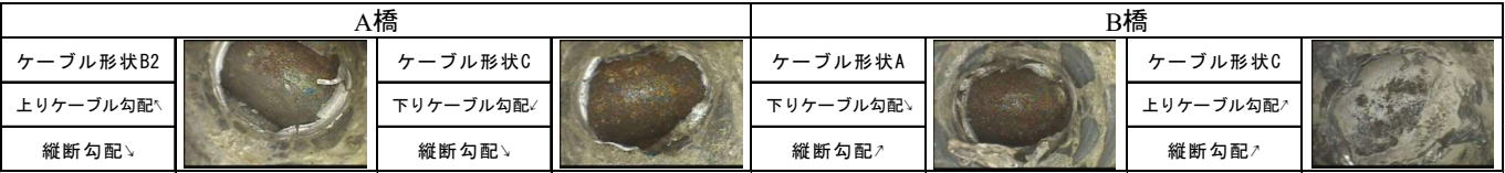
図-4 グラウト充填不足箇所 (A 橋, B 橋)
