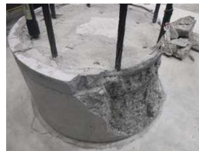
(b) 杭体接合面（南西側）
