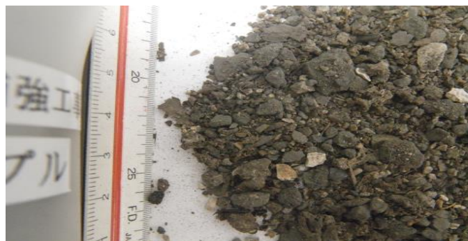
写真-2 土砂化したコンクリートの試料
