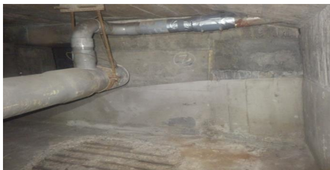
写真-1 排水管和箱桁内下床版の土砂化
