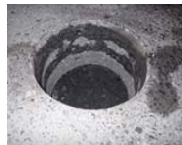
採取1時間後のコア採取坑の状況 (早期劣化区間)
