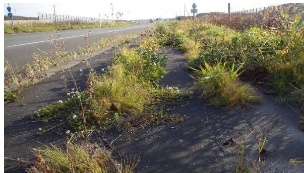
写真-2 歩道の雑草の繁茂状況
