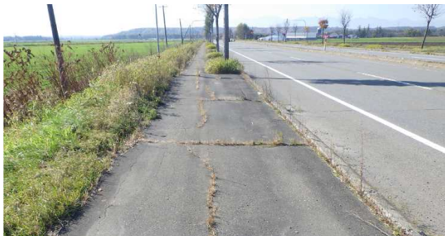
写真-1 歩道の凍上ひび割れおよび低温ひび割れ
