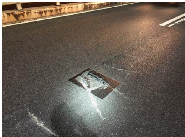
写真-1 損傷状況
