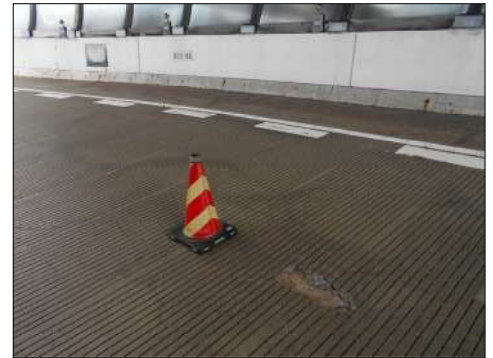
図1 SFRC舗装に生じたポットホール
