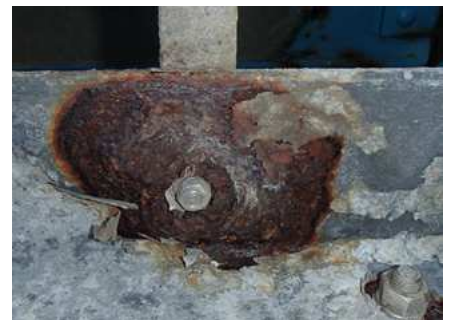
図-2 異種金属接触腐食
