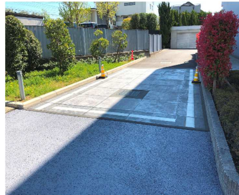
写真-1 建物北側に設置した試験施工箇所 (2箇所)の黄色カラーコーンに日射計を設置
