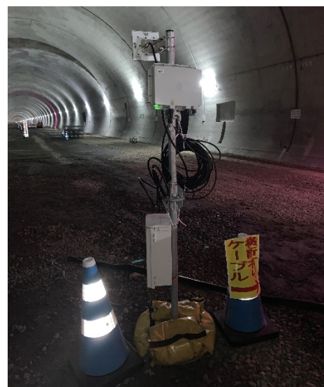
写真-1 無線機器による Wi-Fi 化
