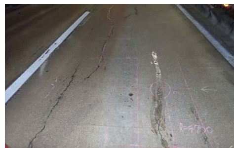
写真-1 ひび割れ状況
