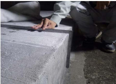
写真 - 3 膨れ測定状況
