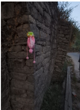
写真-1 蛇籠擁壁の変状
