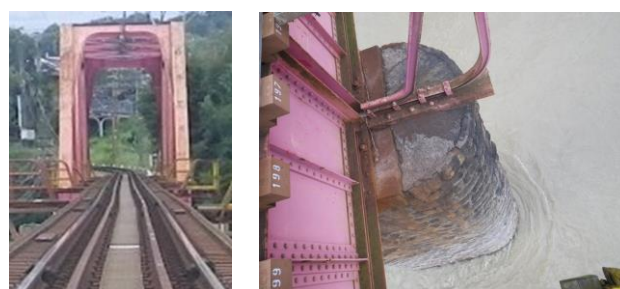
(a) 軌道の変状
