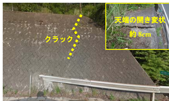
写真-1 ブロック積の縦クラック
