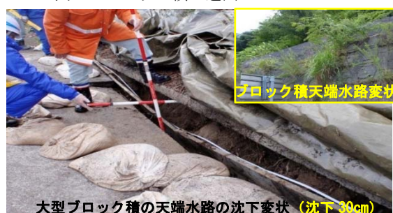
写真-2 ブロック積の天端水路の変状
