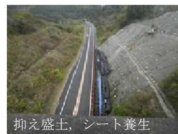
写真 1. 崩壊後の仮設工
