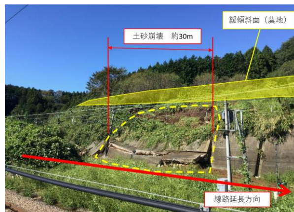
写真2 災害発生翌日の様子（土留壁崩壊）
