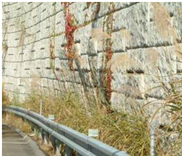
写真 1 補強土壁の変状
