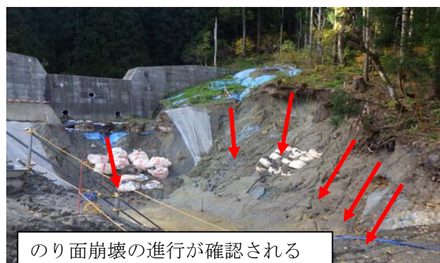
図-2 切土のり面崩壊拡大期
