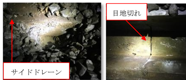
写真-1 サイドドレーン周辺の湧水状況
