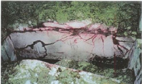
写真-1 坑道底盤の開口割れ目の例 2)
