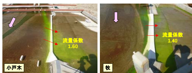
図-2 小戸木・牧の越流状況
