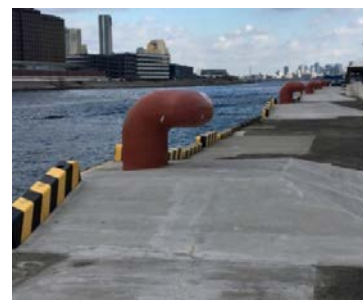
図-1 上部工の嵩上げ事例
