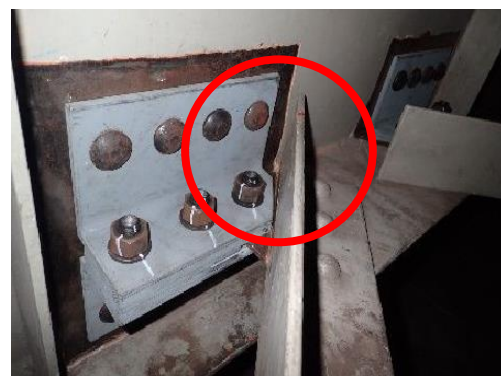
写真-1 L型鋼による当て板困難事例
