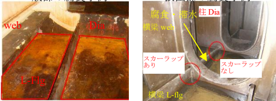
図-3 鋼製橋脚における腐食事例
