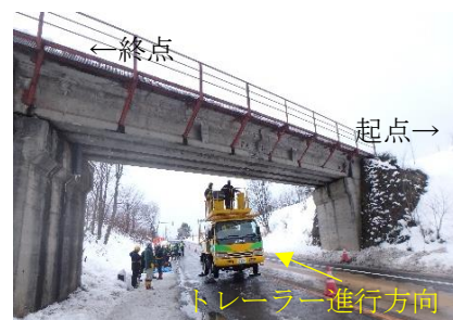
図 1 橋りょうの全景（損傷調査時）
