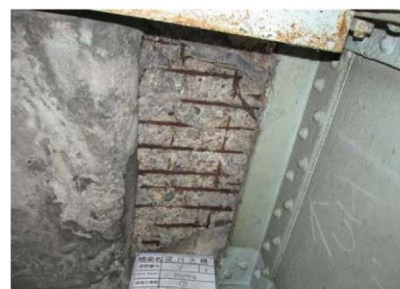
写真-1 床版の剥離・鉄筋露出
