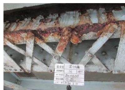
写真-2 鋼部材の腐食
