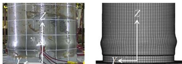
図7 加振終了後のP2橋脚柱の変形状況の比較
