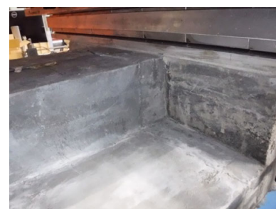
写真-1 圧縮側補強部損傷状況
