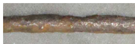
写真-2 素線の腐食状況
