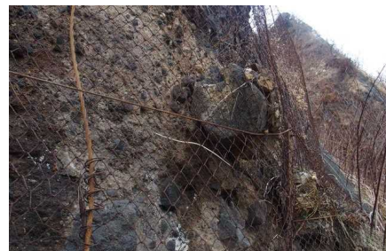
写真-1 腐食した覆式落石防護網 (海岸線から約20m, 廃道)
