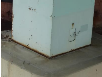
図-1 基部が腐食減肉した鋼製橋脚
