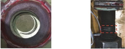
写真-4 KNA-1 NO. 2 ボルト孔 写真-5 損傷したネジ山
