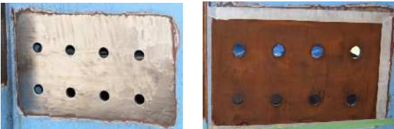
図-1 発錆状況(左：塗布前、右：塗布 24 時間後)
