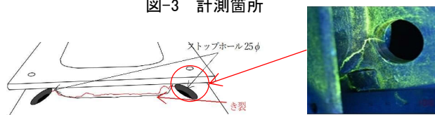
図-4 開口部き裂状況
