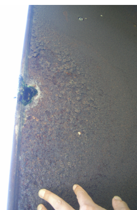
図2 床板下面の漏水周辺の腐食状況
