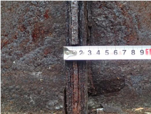
図-5 D 橋 G4 桁外側 垂直補剛材
