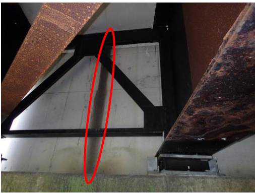
図-3 伸縮装置からの漏水
