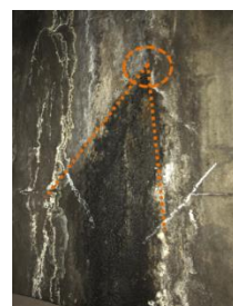
写真-1 地下鉄構内漏水箇所の例
