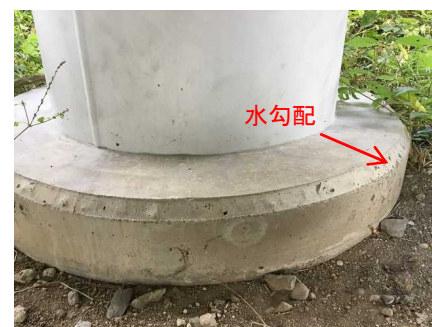
図 3 CFT 柱の地際部
