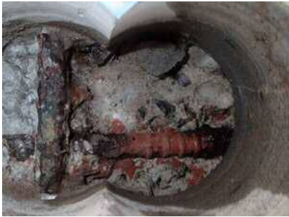
写真3 鉄筋腐食度Ⅳ 2) の例
