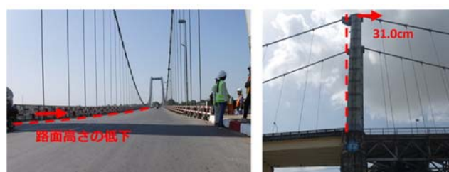
図 2 Pathein 橋の変状例
