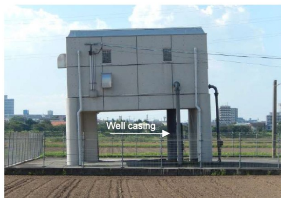
図-1 秋田配水場ポンプ建屋の被害状況 1)
