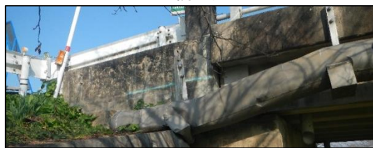
図3 A 橋地点の管路被害
