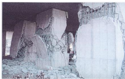
写真-2 共役せん断破壊の橋脚
