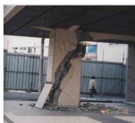
写真-5 車寄せの柱のせん断破壊
