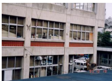
写真-4 中間柱のせん断破壊
