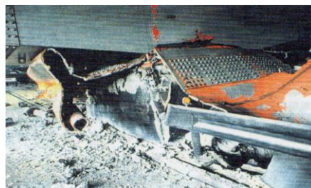
写真-3 圧壊した鋼製橋脚
