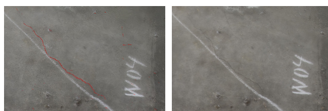
(c) ひび割れ位置を反映した 3 次元モデルの表面 (d) 通常の 3 次元モデルの表面
