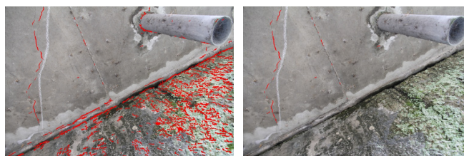
(a) 撮影画像から直接ひび割れ検出を行った結果 (b) 床版特定によってひび割れ検出を行った結果
