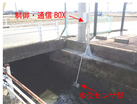
図-2 IoT 水位監視システム設置状況
