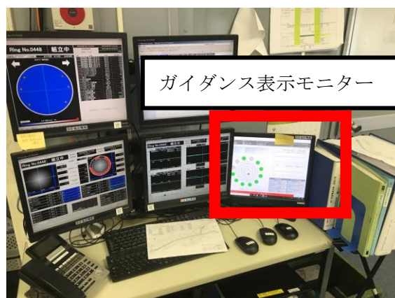
図-2 事務所内設置状況
