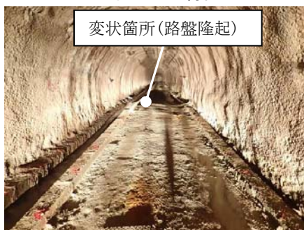
写真-1 変状箇所全景
