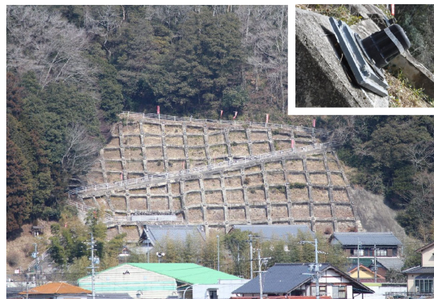
写真-1 検討対象箇所全景とアンカー頭部浮き状況
