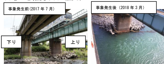
図-5 根固め工沈下状況
